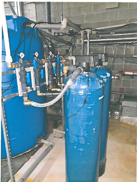
Úprava vody pro ledové plochy.
