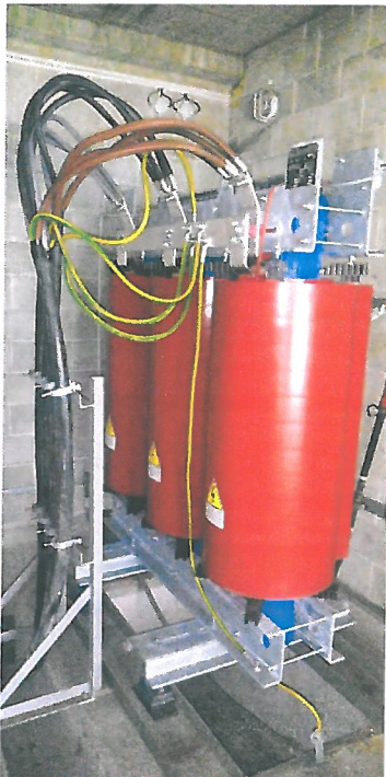
Transformátory na hlavní hale.
